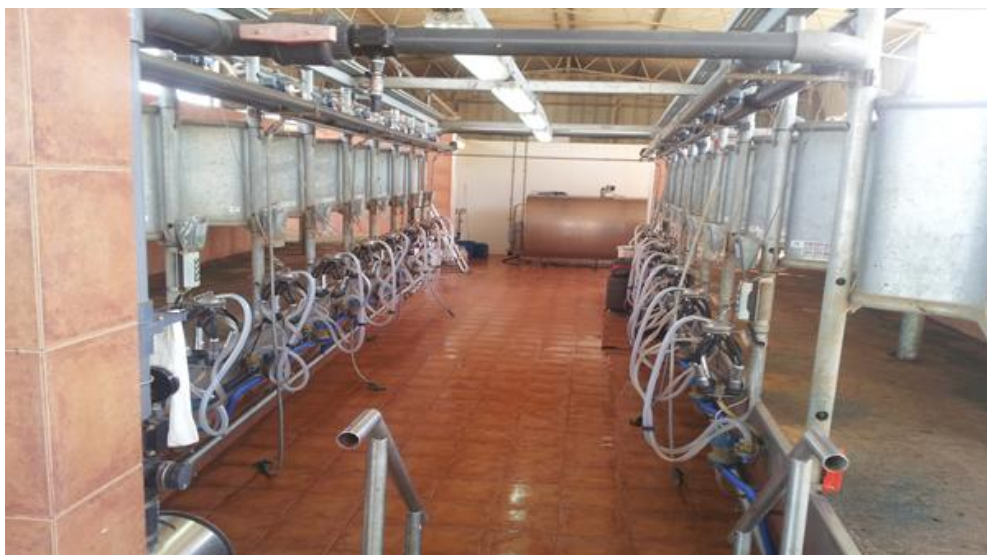
Figura Nº 13 – Sala de ordenha da Aldeia 12.
